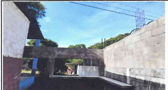
Foto 4: Lámina dañada por el viento y cambio de estructura.
