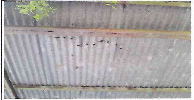
Foto 2: Lámina en mal estado.
