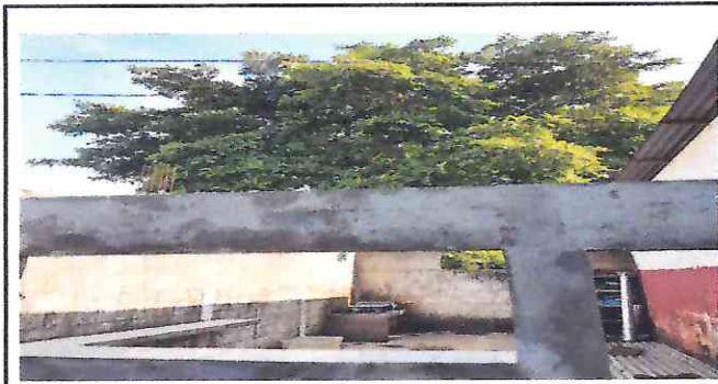
Foto 3: Lámina dañada por el viento y cambio de estructura.
