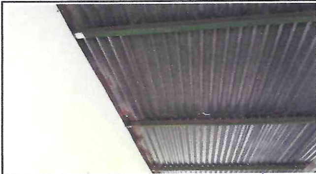
Foto 1: Lámina en mal estado.
